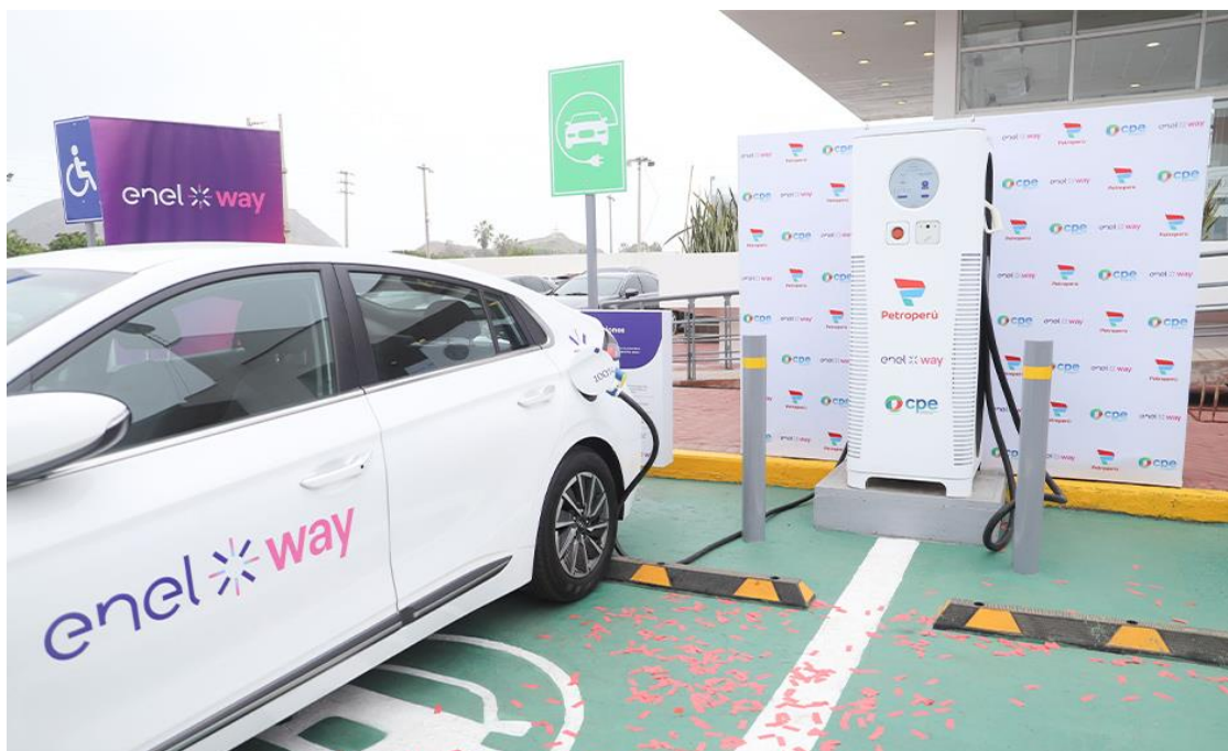
Figura No 9.- Estación de recarga eléctrica ( electrolinera) para auto eléctrico.
